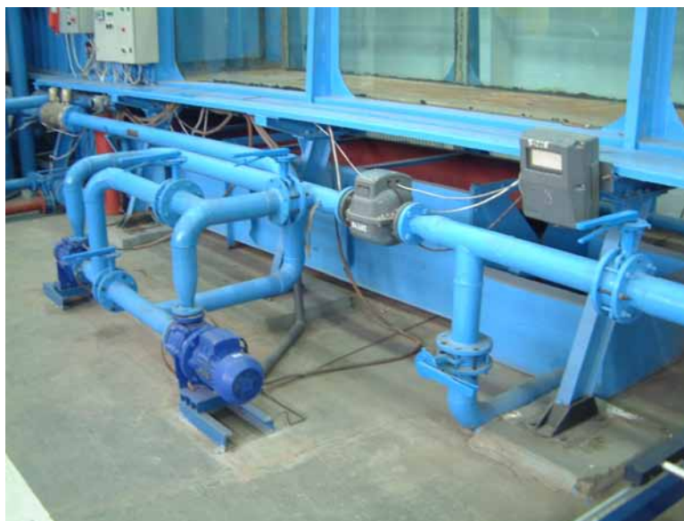
Instalatie fabricata pentru Universitatea Tehnica de Constructii, Hidraulica si Protectia Mediului
